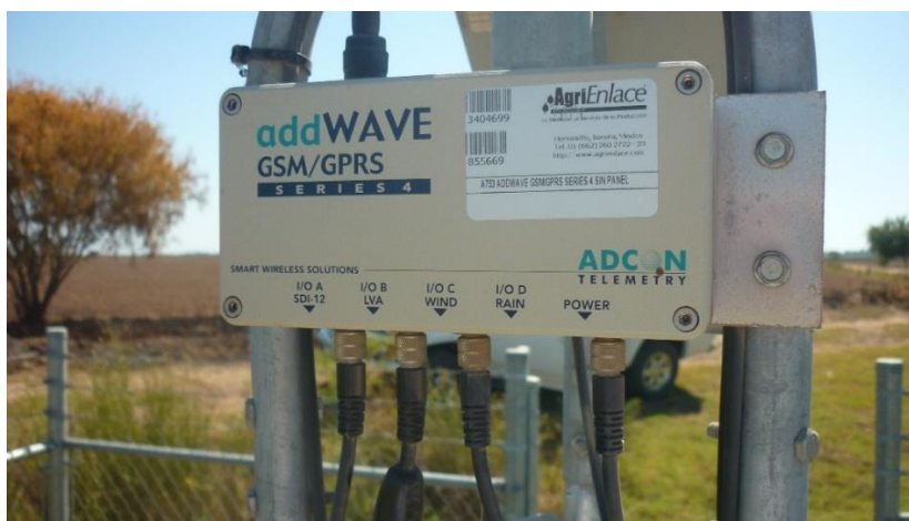
Figura 13. Fotografía de una Unidad de Transmisión Remota.
